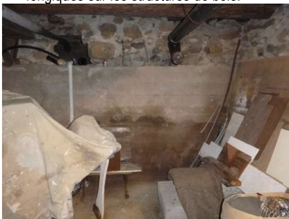
Photo 15 : Sous-sol, partie arrière. Le bas des murs de fondation était humide.
