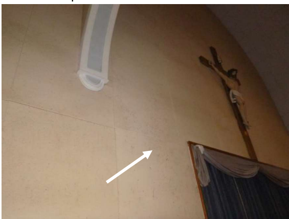
Photo 5 : Église 1 e étage. Des taches de moisissures sont visibles sur les murs avant et arrière.
