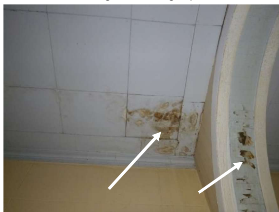
Photo 4 : Église 1 e étage, partie avant. Matériaux poreux détériorés par l'eau au plafond.
