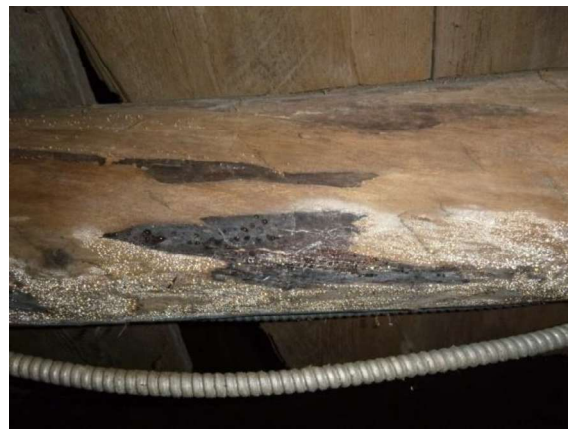
Photo 20 : Sous-sol, partie avant. Poutres de bois affectées par la moisissure.
