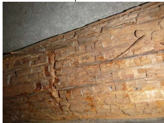
Photo 22 : Sous-sol, partie avant. Pourriture cubique au niveau d'une structure de bois. Matériau sec.
