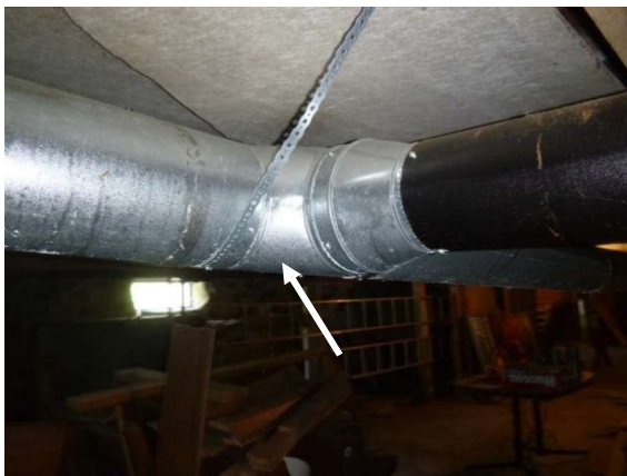
Photo 21 : Sous-sol, partie avant. Condensation visible sur les tuyaux.
