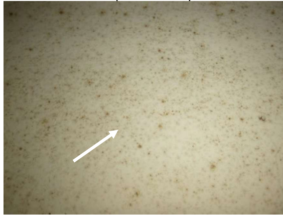
Photo 6 : Église 1 e étage. Des taches de moisissures sont visibles sur les panneaux cartonnés des murs.
