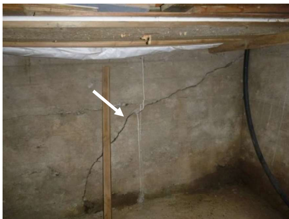
Photo 16 : Sous-sol, partie arrière. Des fissures étaient visibles.
