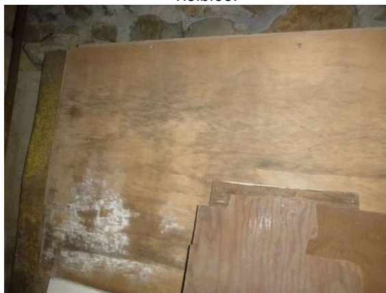
Photo 18 : Sous-sol, partie arrière. Des articles et matériaux entreposés sont détériorés par l'eau et présentent des taches suspectes.
