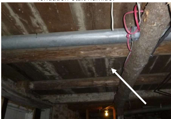
Photo 17 : Sous-sol, partie arrière. Taches qui s'apparentent à des moisissures sous plusieurs planches au plafond.
