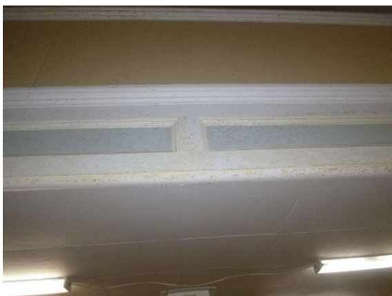
Photo 7 : Église 1 e étage, partie avant. Moisissures visibles sur les surfaces du balcon de la mezzanine.
