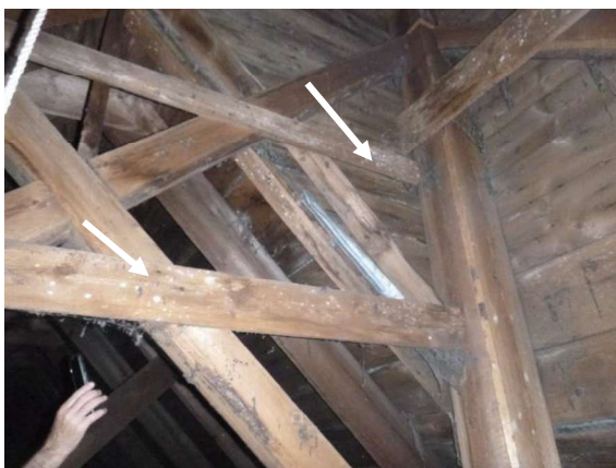
Photo 13 : Comble. Taches blanches d'apparence fongiques sur les structures de bois.
