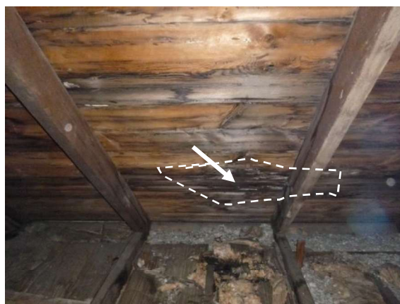
Photo 12 : Comble. Cernes, taches visibles et matériaux humides sous la toiture.
