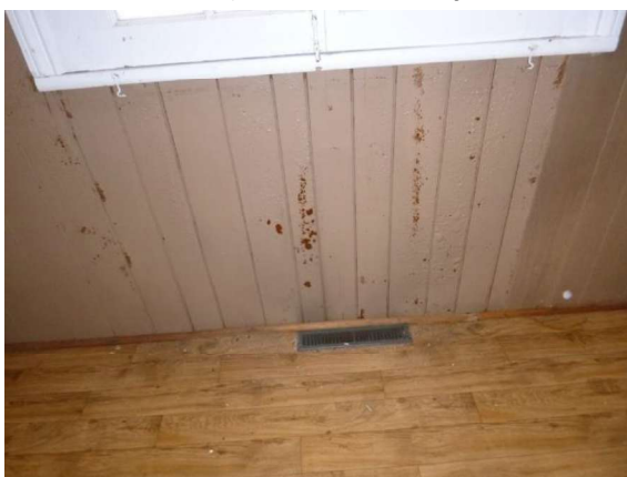
Photo 3 : Église 1 e étage, partie avant. Peinture détériorée par l'humidité sous les fenêtres.
